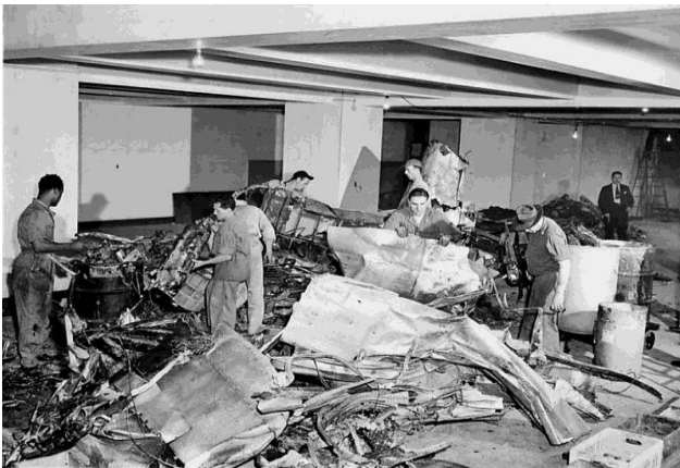
Foto sopra e a lato: Operai al lavoro al 78esimo piano dell'Empire State Building per riparare i danni dell'incidente aereo, New York, 30 luglio 1945
